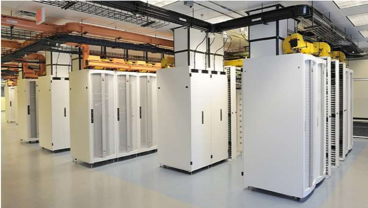
图例（十二）：国外某大型数据中心安装实例
